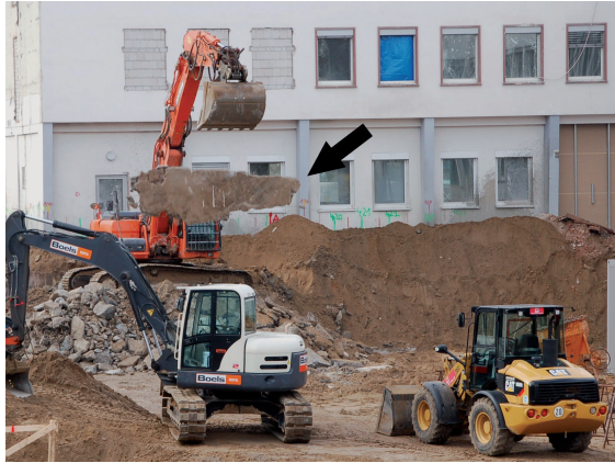
Abb. 3.6.4-5 Nicht sachgerechte Zerkleinerung von Abbruchmaterialien durch Fallenergie (Quelle: R. Schöwer)
